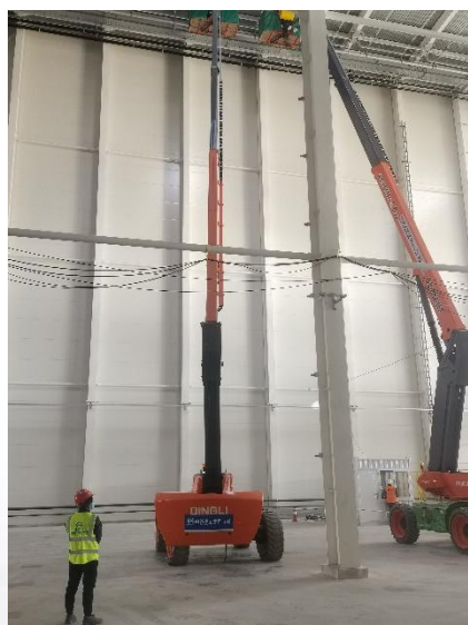
24米直臂车安装桥架
